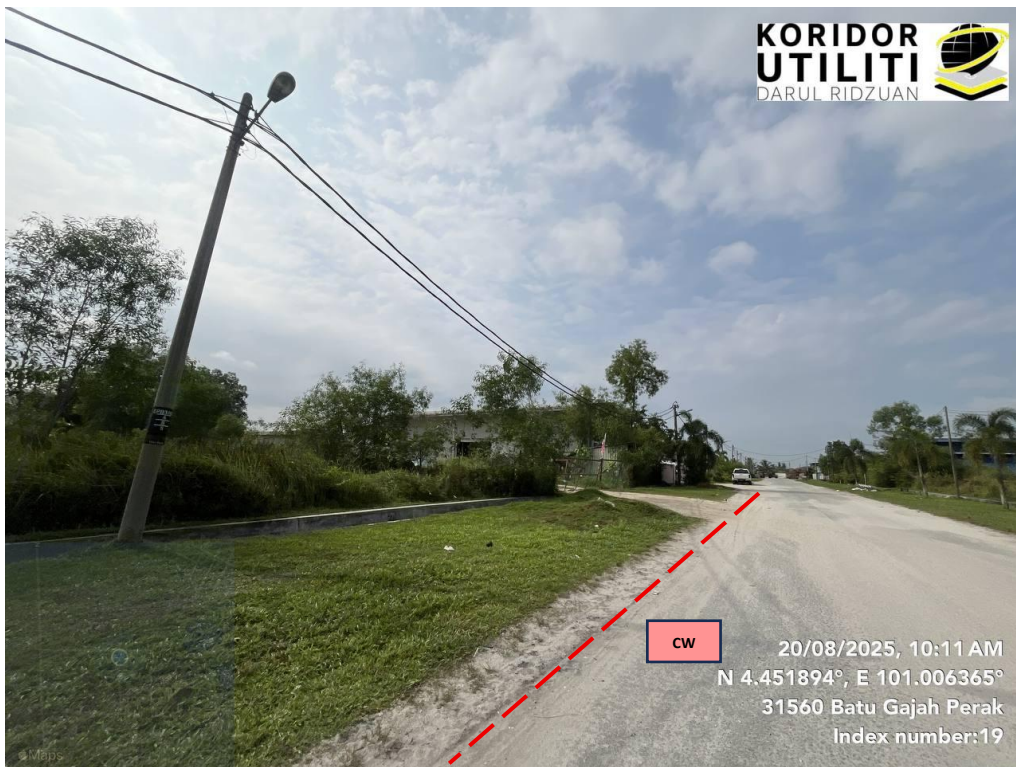
JAJARAN KOREKAN TERBUKA DI LALUAN BEMBAN 15
