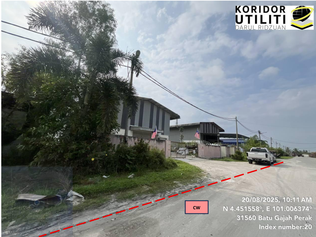
JAJARAN KOREKAN TERBUKA DI LALUAN BEMBAN 15
