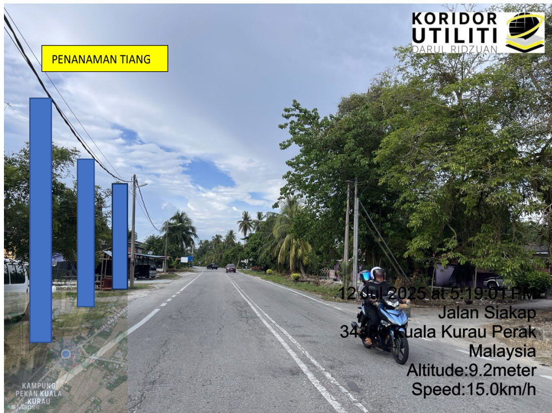
LOKASI DI JALAN PANTAI
