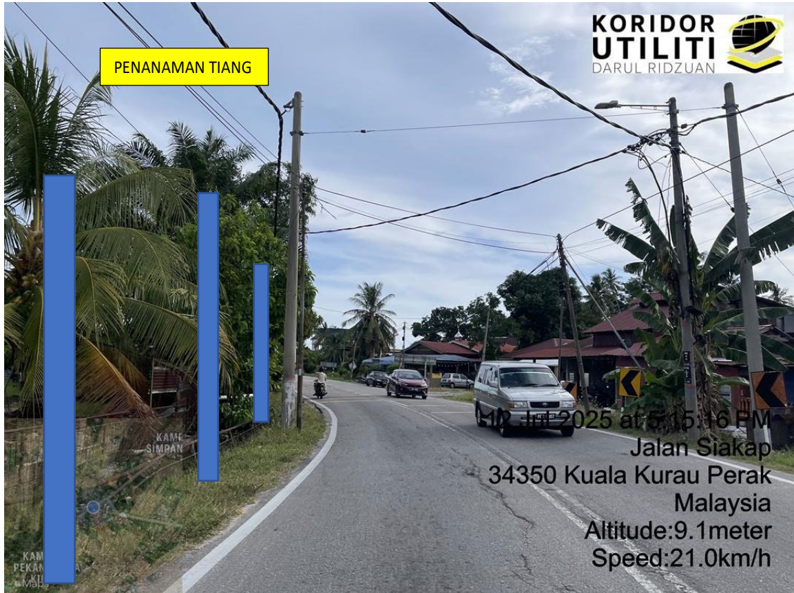
LOKASI DI JALAN PANTAI
