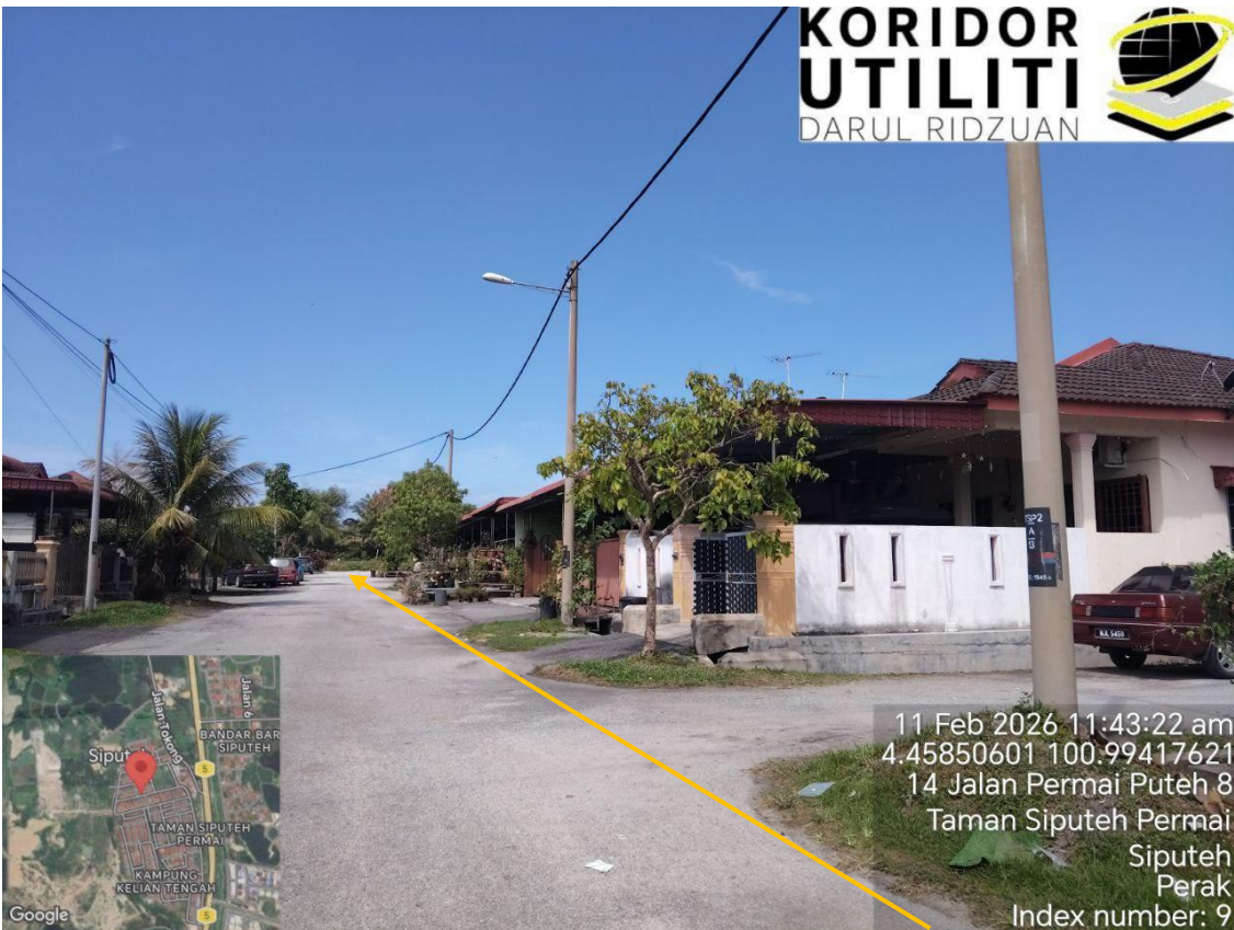
KOREKAN TERBUKA DI JALAN BERTURAP
