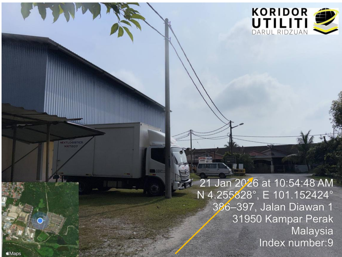
KOREKAN TERBUKA DI JALAN BERTURAP
