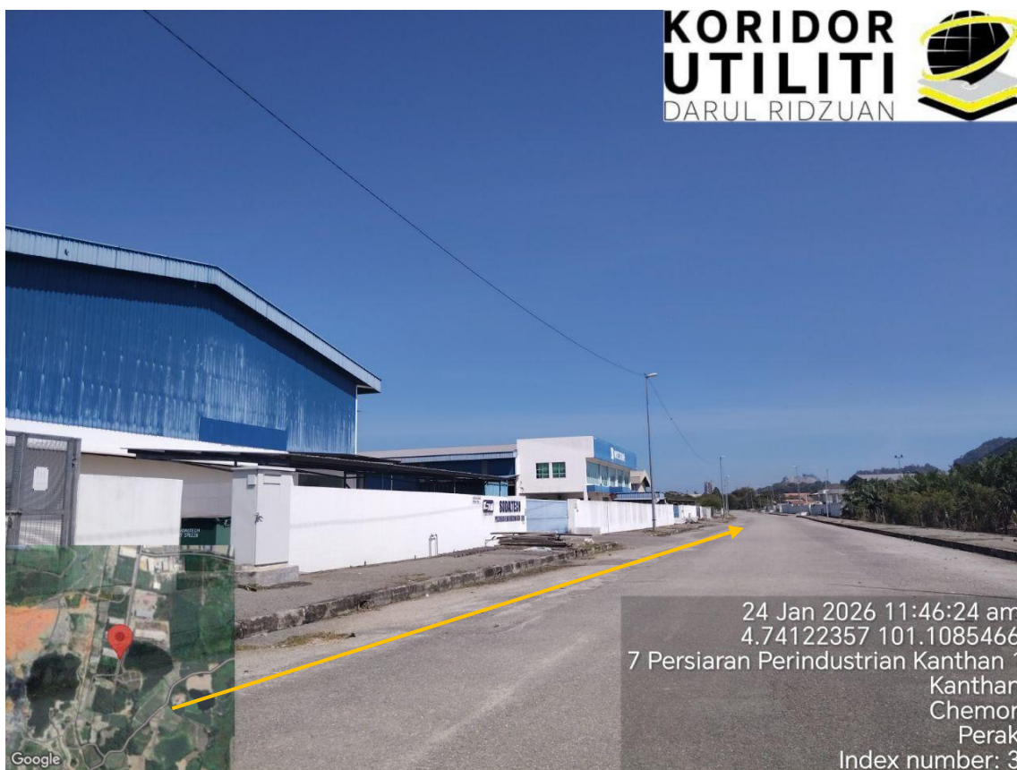
KOREKAN TERBUKA DI JALAN BERTURAP
