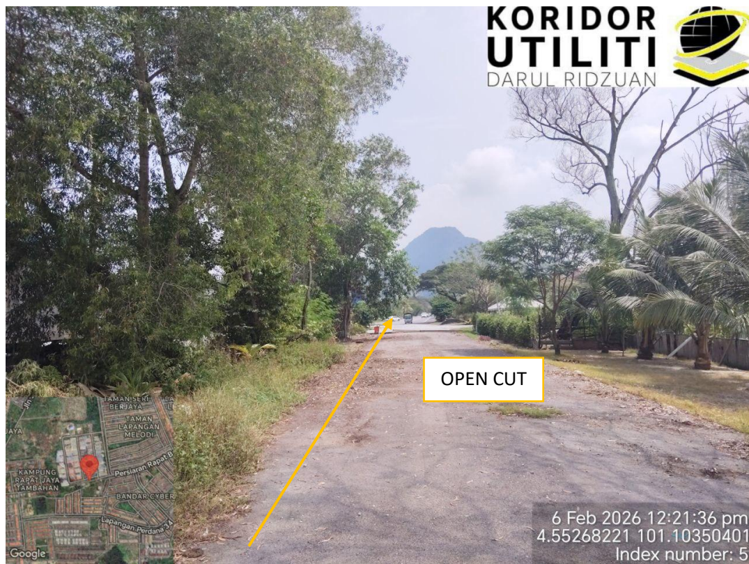
KOREKAN TERBUKA DI JALAN BERTURAP
